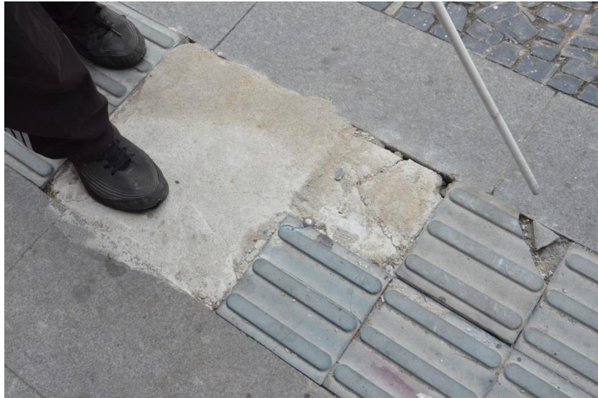
Figura 19 - Falta de manutenção do piso tátil
