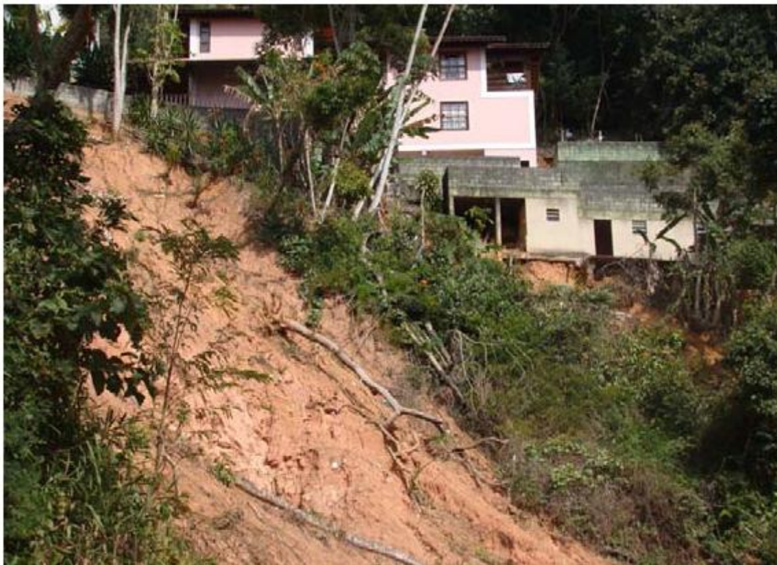
Figura 29: Deslizamento em área ocupada considerada de risco, acima da Praça do suspiro.
