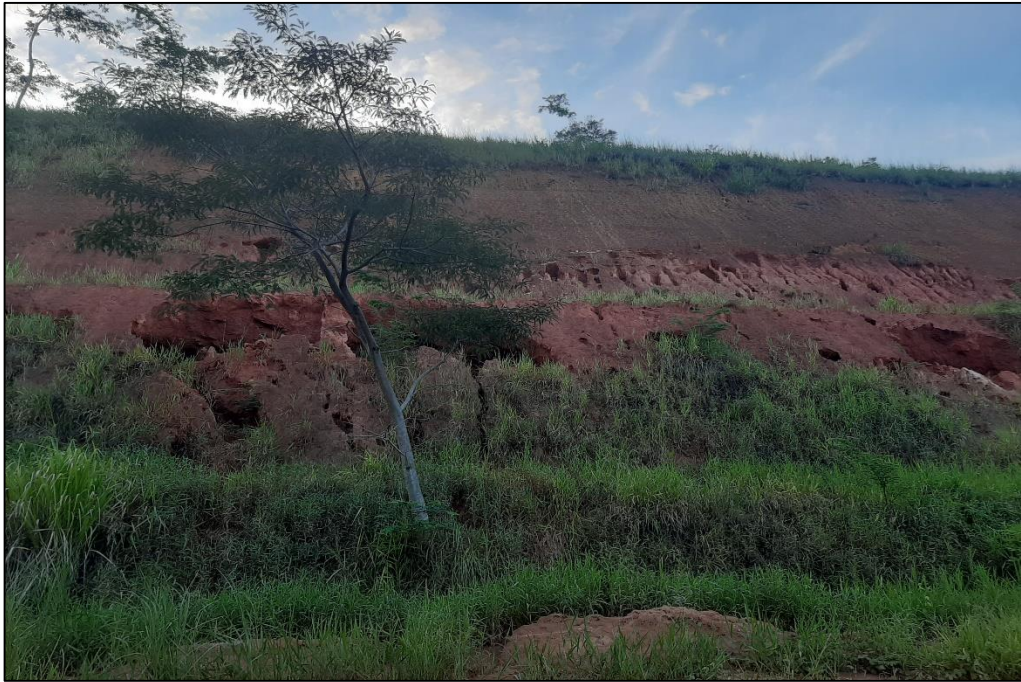
Figura 20: Voçorocas e ravinas se formando em taludes de corte
