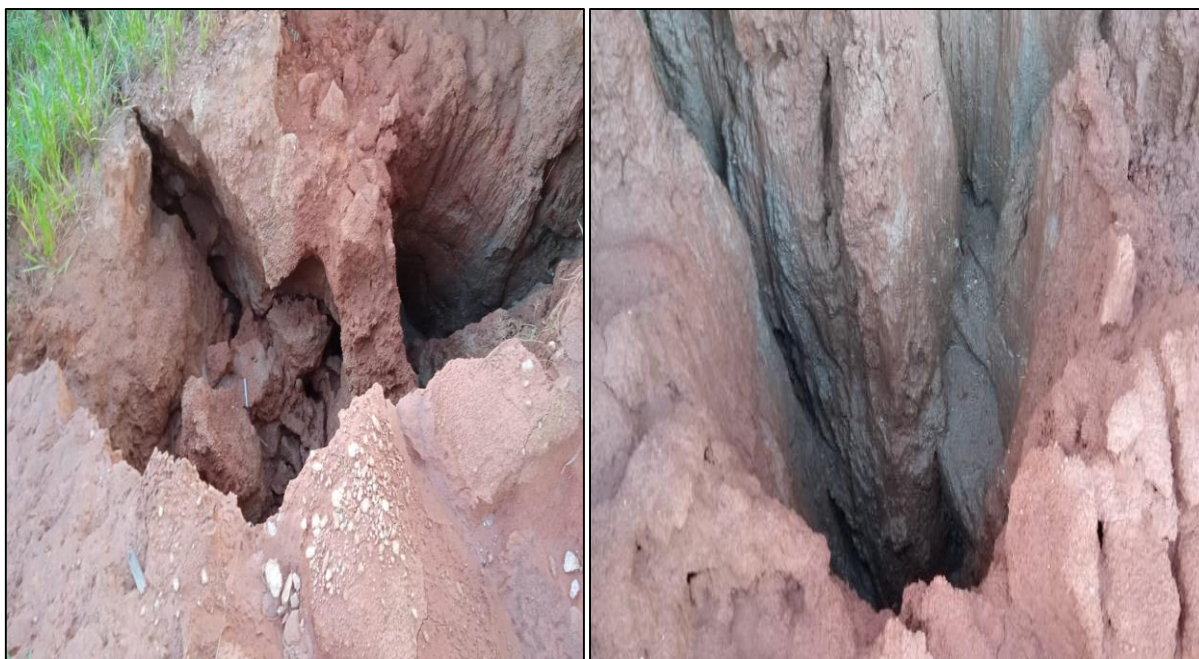
Figura 22: Visão interna de erosão em talude presente na bacia em dois níveis de aproximação: 22(a) e 22(b) e presença de material erodido friável.
