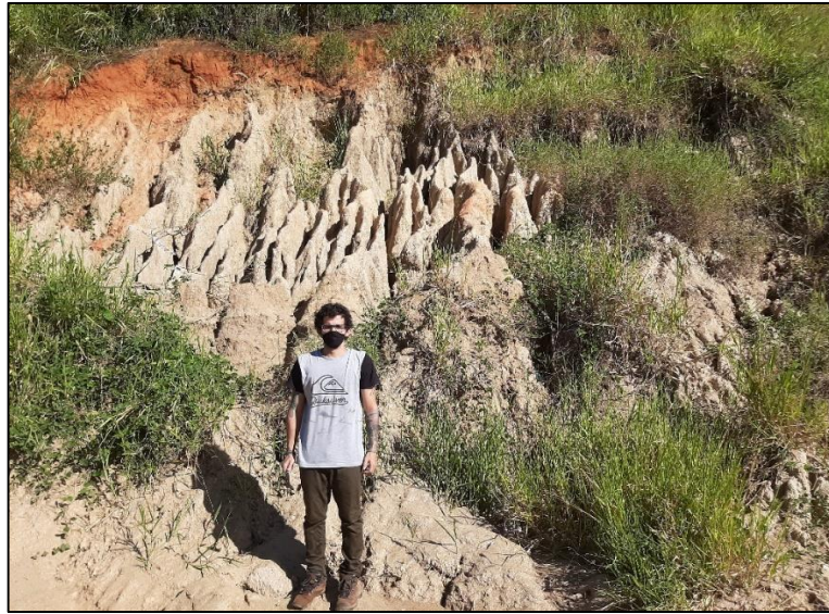
Figura 17: Processos erosivos iniciais, com sulcos/ravinas em base de encosta.
