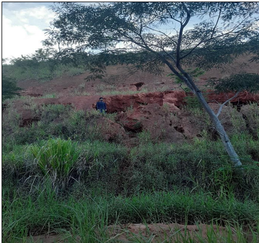
Figura 21: Detalhe da porção esquerda da fotografia anterior destacando uma voçoroca desconectada ativa presente em talude
